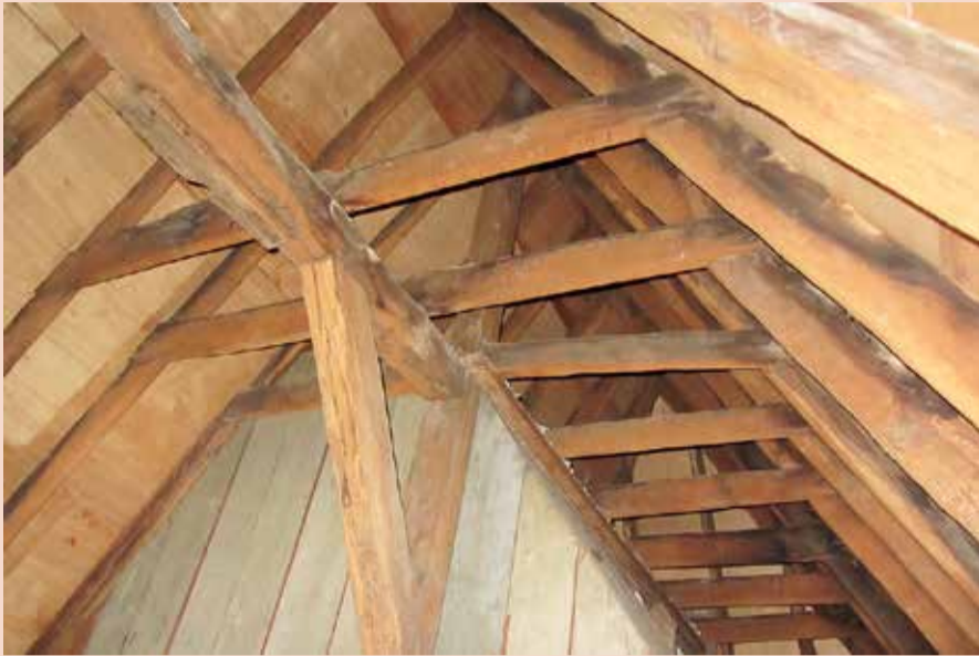
De zwaar uitgevoerde houten kapconstructie met centraal langverband verradt dat er van origine op deze kap een zwaardere bedekking heeft gelegen dan stro. Foto: W.G. van Reenen.
