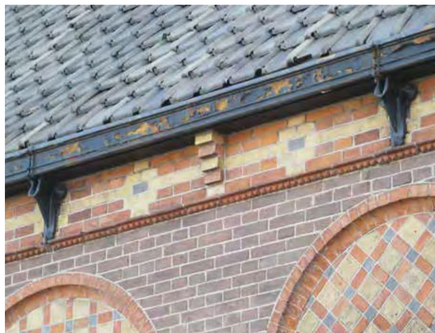
De gietijzeren goten worden in het midden van de gootelementen gedragen door een uitgemetselde console en aan de uiteinden door gietijzeren consoles. Die kunnen lekwater bij de verbindingen van de gevel afhouden. Afbeelding: W.G. van Reenen.
