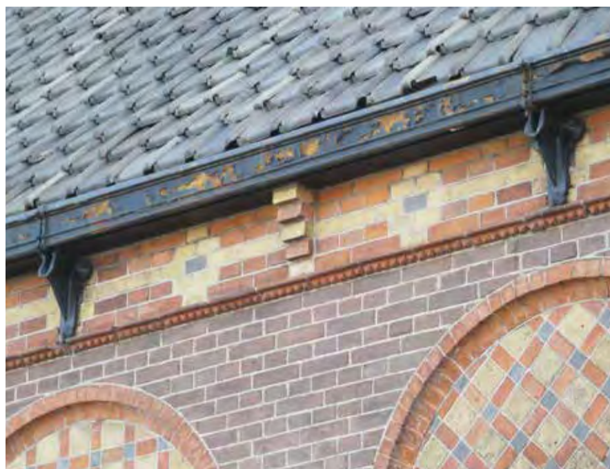
De gietijzeren goten worden in het midden van de gootelementen gedragen door een uitgemetselde console en aan de uiteinden door gietijzeren consoles. Die kunnen lekwater bij de verbindingen van de gevel afhouden. Afbeelding: W.G. van Reenen.
